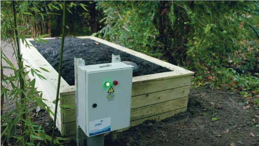
Bovengrondse IBA met bruinkoolbed. (Foto Pidpa)
